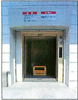
荷物用エレベーター
