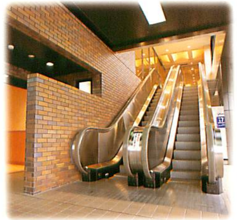
館内移動にも配慮して 設備配置をしています
